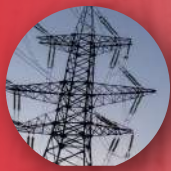
Líneas de transmisión
